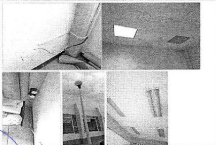
Instalación eléctrica e iluminación (Edificios "C", "F", Vinculación, Laboratorios, Biblioteca)
