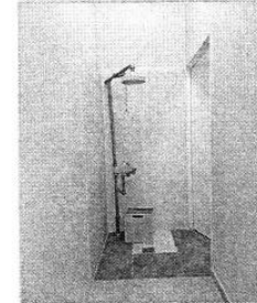
REGADERA DE EMERGENCIA EN CLÍNICA INTEGRAL UNIVERSITARIA
