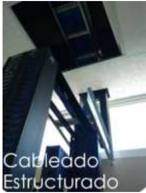
Imagen 35. Rack de Comunicaciones
