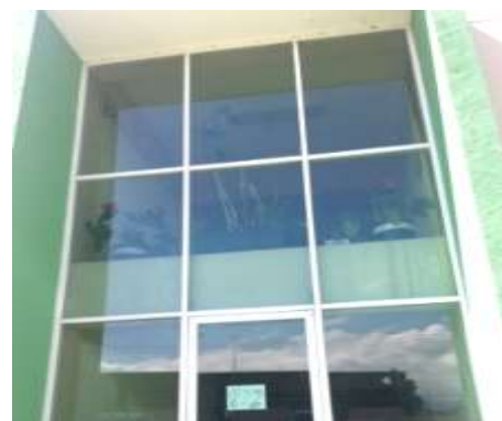
Imagen 45. Mantenimiento de cristales estrellados.
